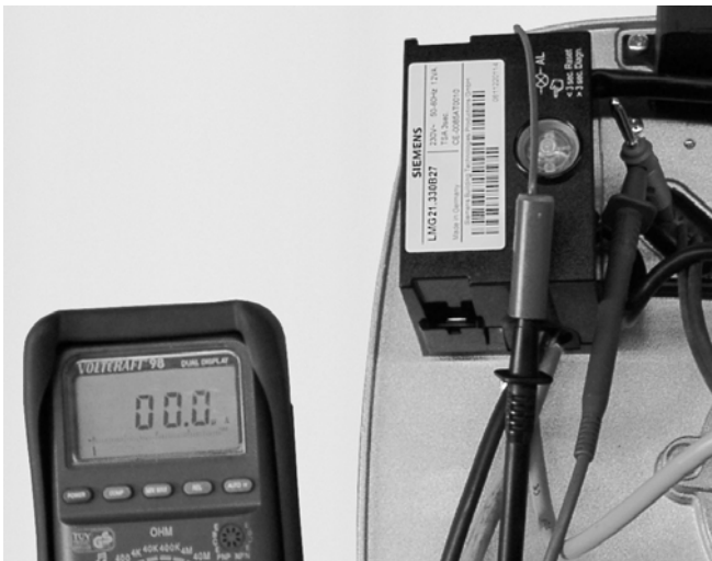
Abb. 22: Die beiden Messkabel des Multimeters an die beiden Enden angeschlossen.
